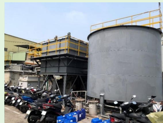
桃園總部廢水處理設施
